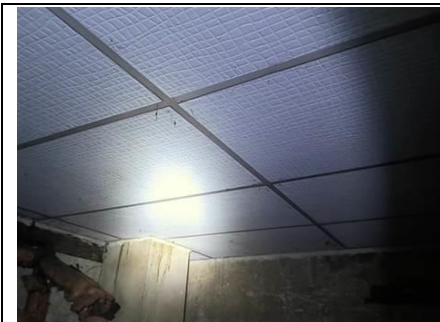
Photo n° PhA001 Localisation : Rez de chaussée - LOCAL CHAUDIÈRE Ouvrage : 4 - Plafonds et faux plafonds - Faux plafonds Partie d'ouvrage : Panneaux et plaques Description : plaques faux plafonds Localisation sur croquis : M001
