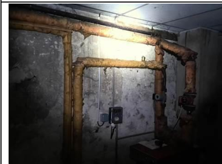
Photo n° PhA002 Localisation : Rez de chaussée - LOCAL CHAUDIÈRE Ouvrage : 6 - Conduits et accessoires intérieurs - Conduits de fluides (air, eau, vapeur, fumée, échappement, autres fluides) Partie d'ouvrage : Calorifuge (tresses, coquilles, matelas...) Description : Calorifuge (tresses, coquilles, matelas...) Localisation sur croquis : M002
